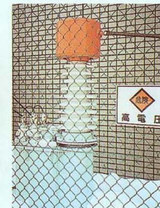
試験用変圧器 (屋外)
